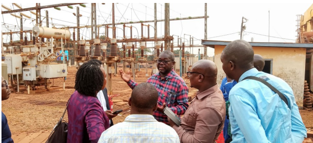
SOUS- STATION B DE GOBONGO
