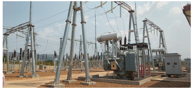
SOUS-STATION DE DANZI
